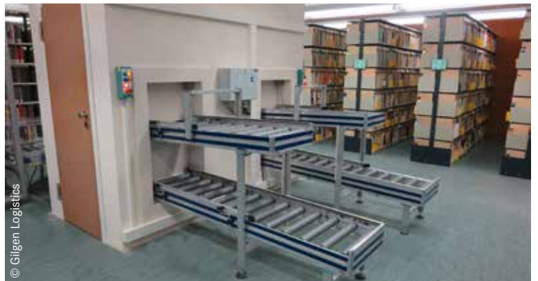
Das automatische Medienfördersystem verbindet die Magazinbereiche mit der Ausleihe, der Buchrückgabe und der Poststelle.
